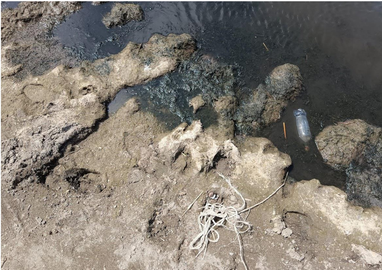
Այստեղ երևում են նախկինում եղած և այժմ ամենայն հավանականությամբ չգործող ֆիլտրող ենթակառուցվածքի հետքեր.
